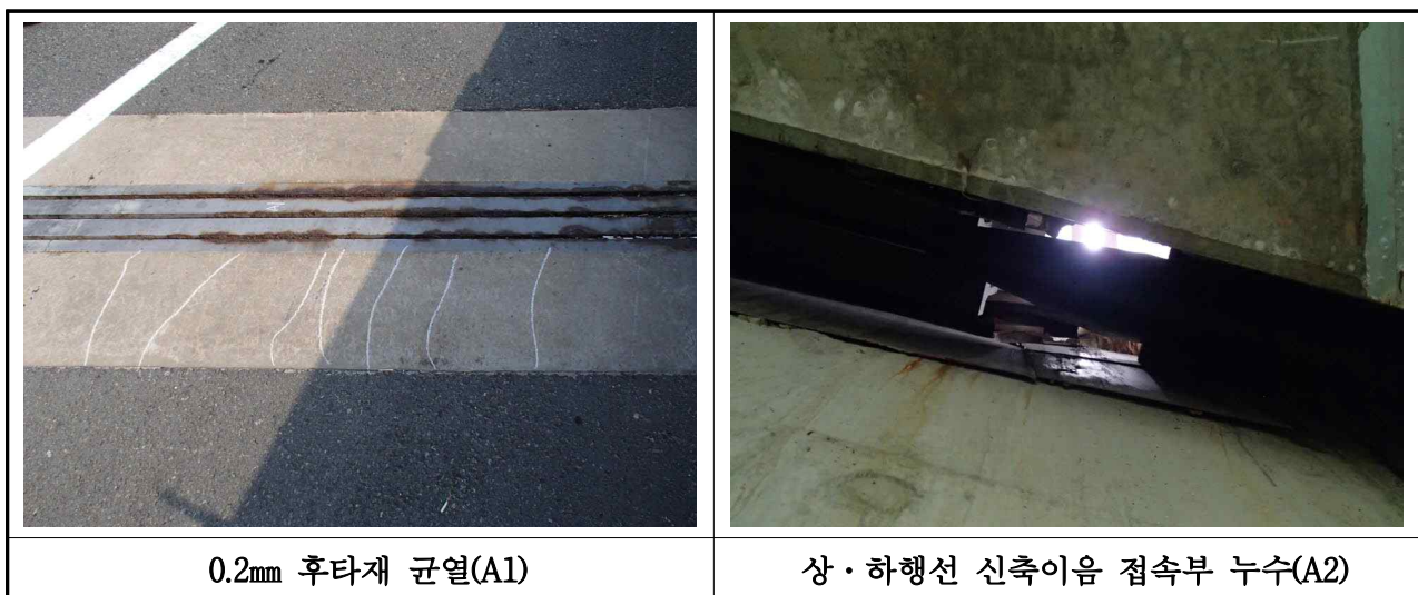
【사진 3.2.15】 신축이음장치 손상현황(대구)
