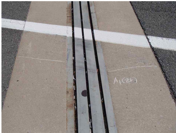
0.2mm 후타재 균열(A1)
