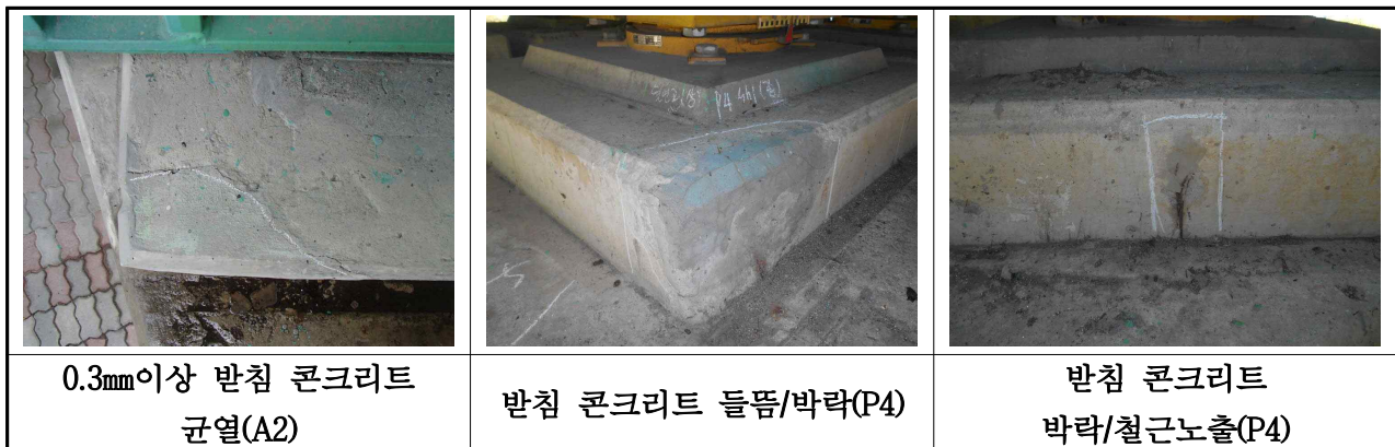
【사진 3.2.13】 교량받침 손상현황(대구)
