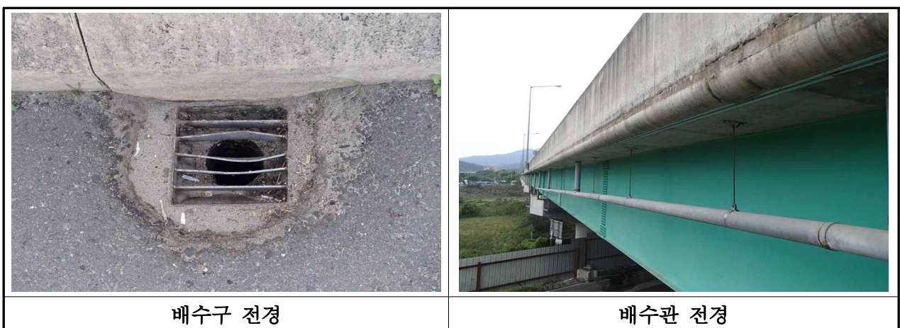
【사진 3.2.19】 배수구 및 배수관 전경(대구)
