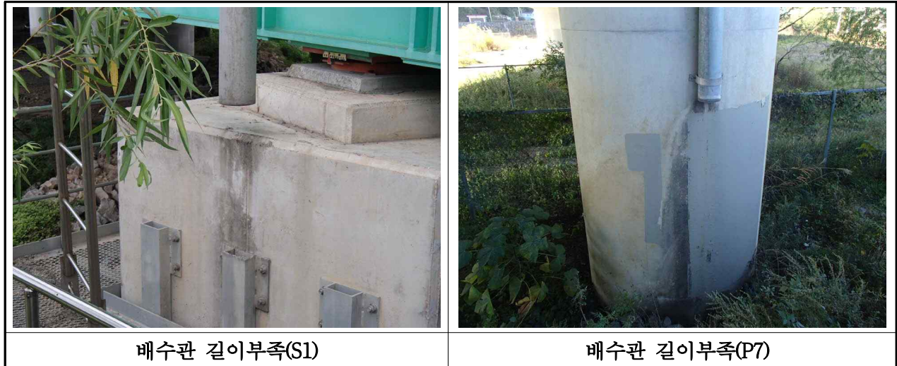
【사진 3.3.20】 배수시설 손상현황(부산, 계속)
