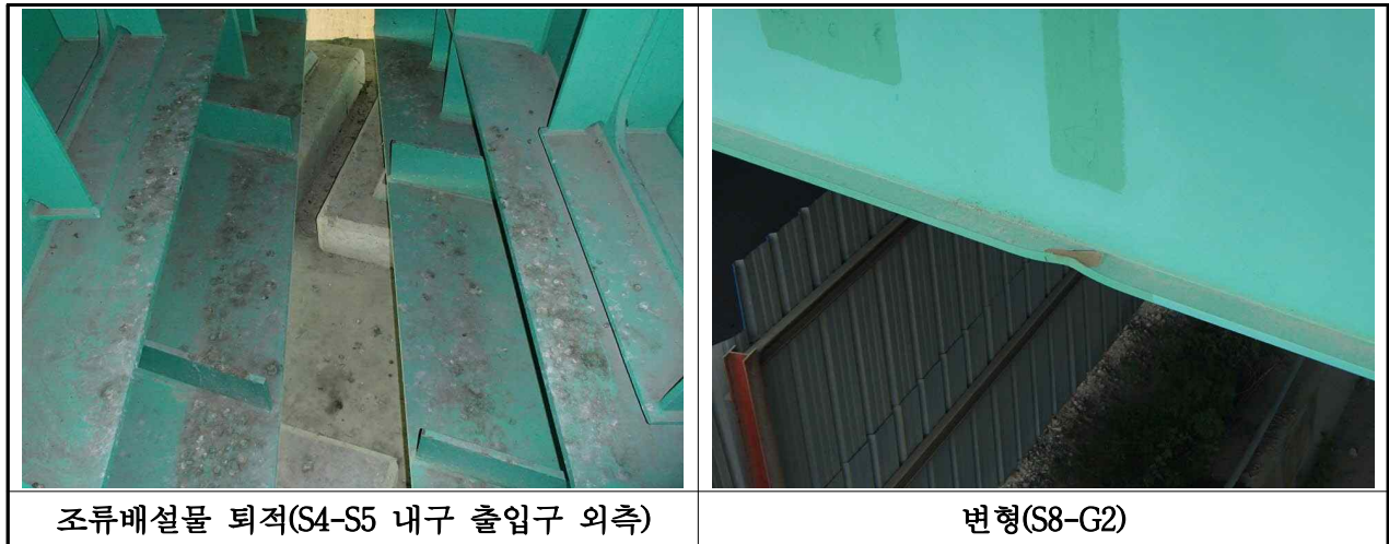
【사진 3.2.5】 강박스 거더 외부 손상현황(대구, 계속)
