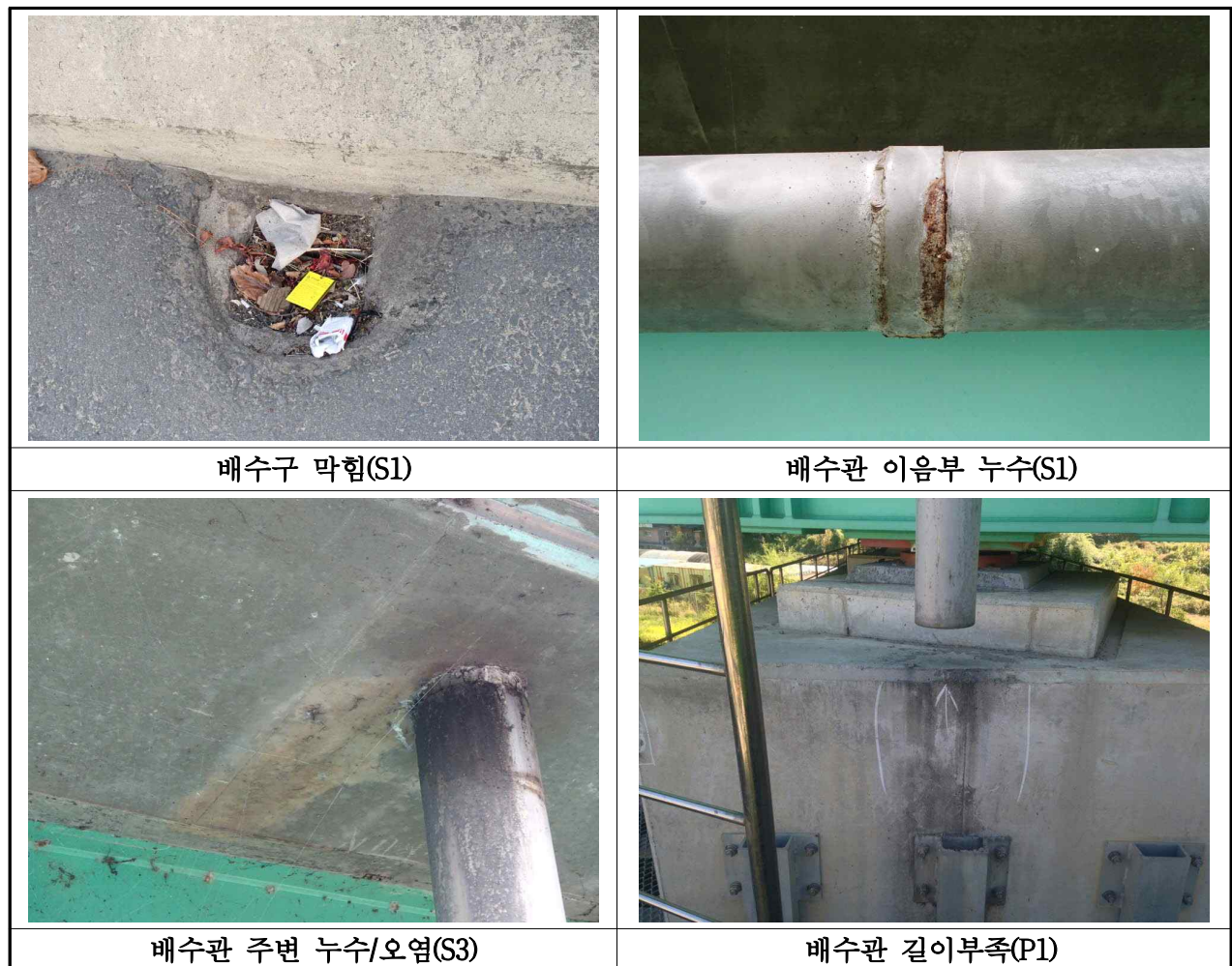
【사진 3.2.20】 배수시설 손상현황(대구)
