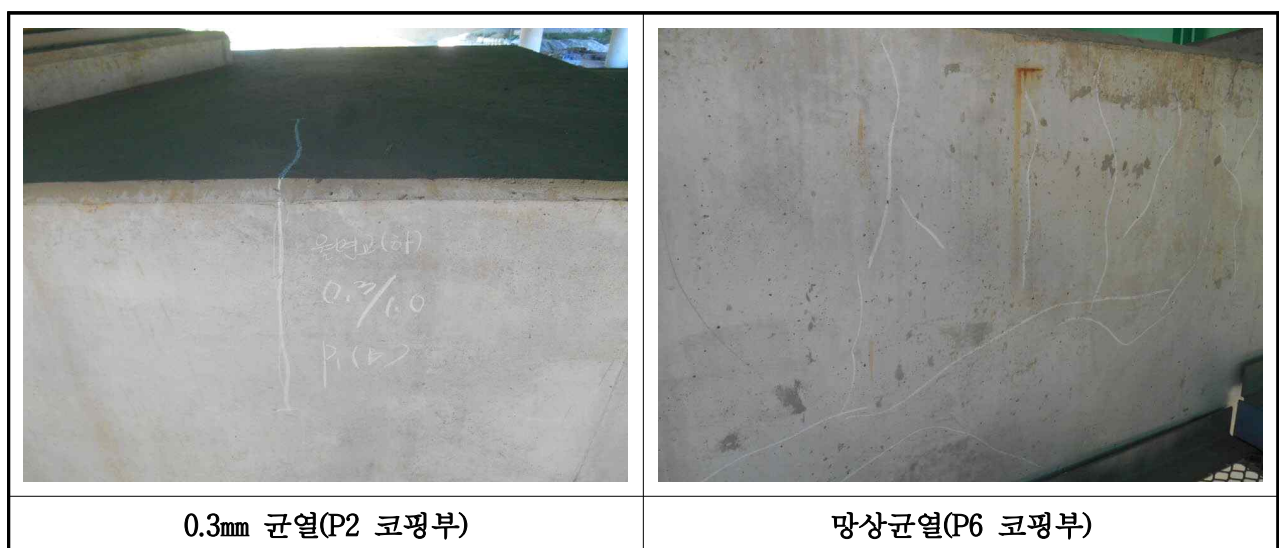
【사진 3.3.10】 교각 손상현황(부산)
