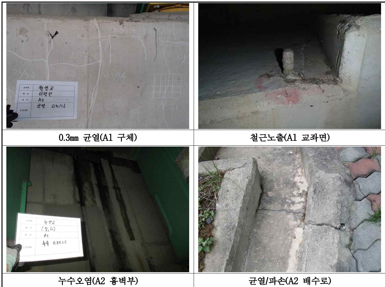
【사진 3.3.8】 교대 손상현황(부산)
