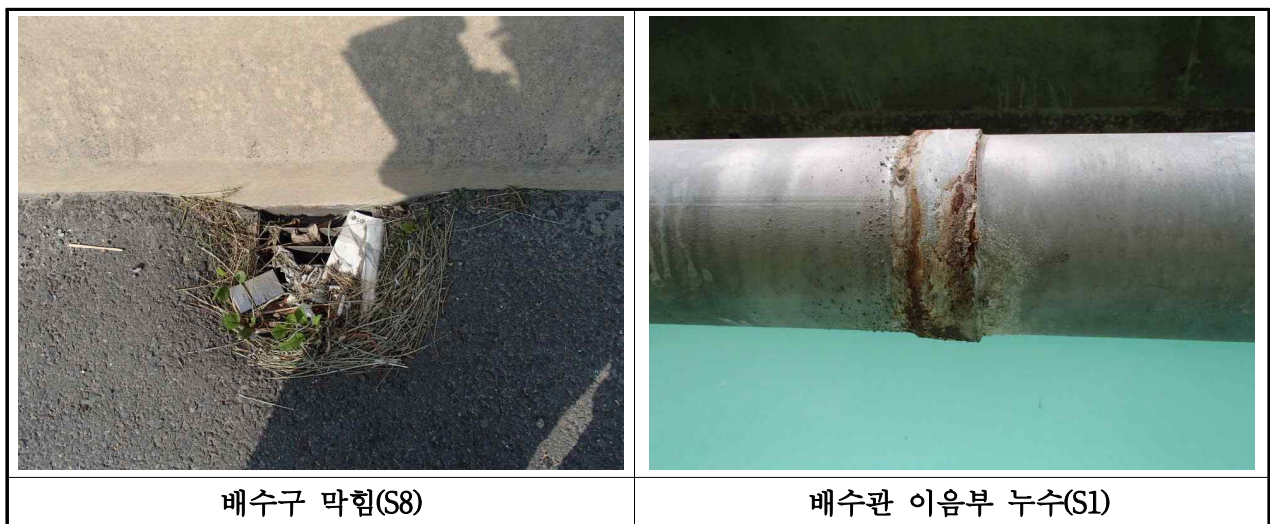
【사진 3.3.20】 배수시설 손상현황(부산)
