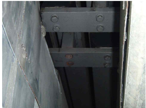
신축이음 하부 유간조절장치 볼트탈락(A2)
