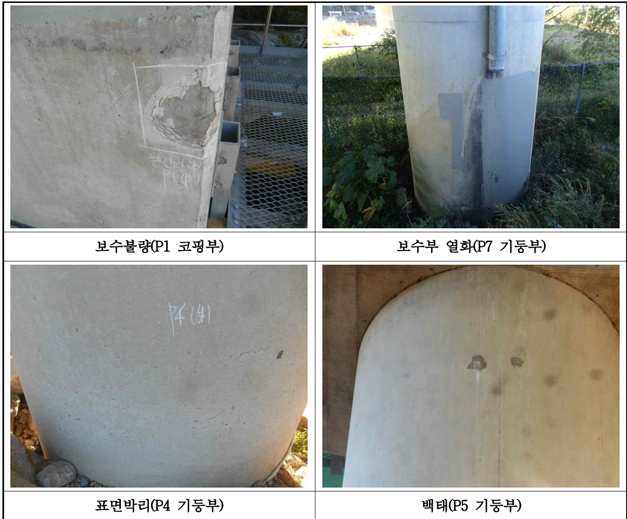
【사진 3.3.10】 교각 손상현황(부산, 계속)
