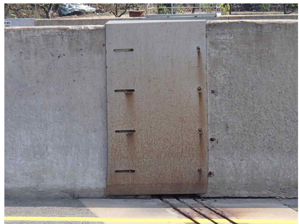
차수판 앵커볼트 탈락(A1)
