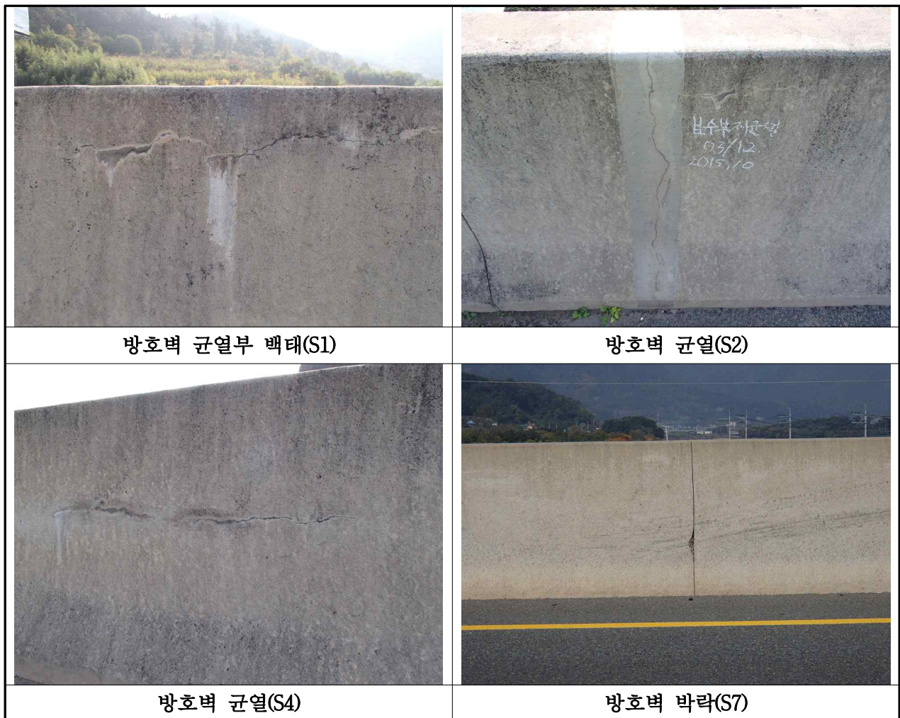
【사진 3.2.22】 방호벽 및 중앙분리대 손상현황(대구)
