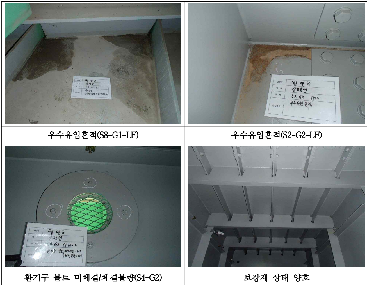
【사진 3.2.4】 강박스 거더 내부 손상현황(대구)
